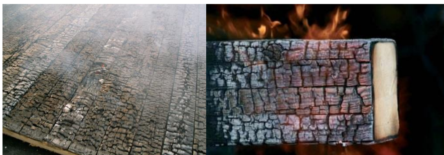
Obr. 2 Masivní dřevěné prvky po požáru (stěna z CLT a dřevěný nosník)
